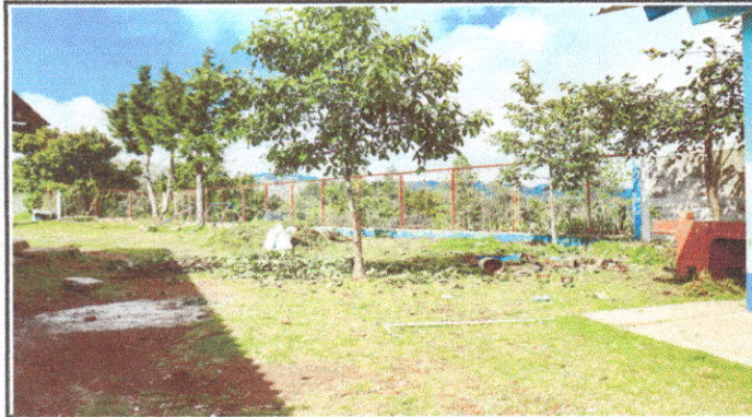
Foto 7: reparación de muro perimetral de block con tubo ng y malla garbanizada, soleras intermedias y columnas.
